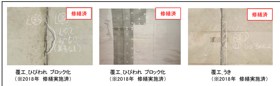
図-3 トンネルの主な変状
