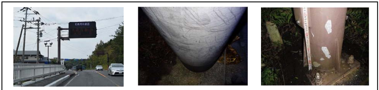
図-7 道路情報提供装置の主な変状
