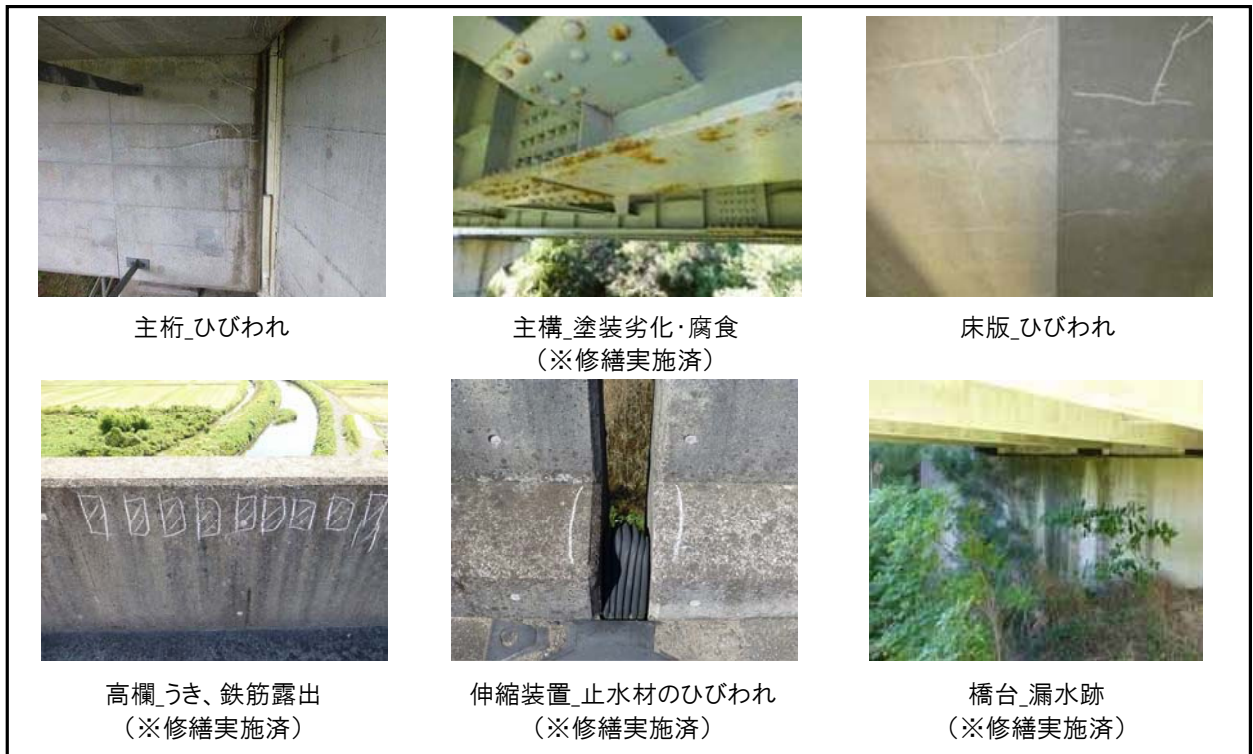
図-2 橋梁の主な変状
