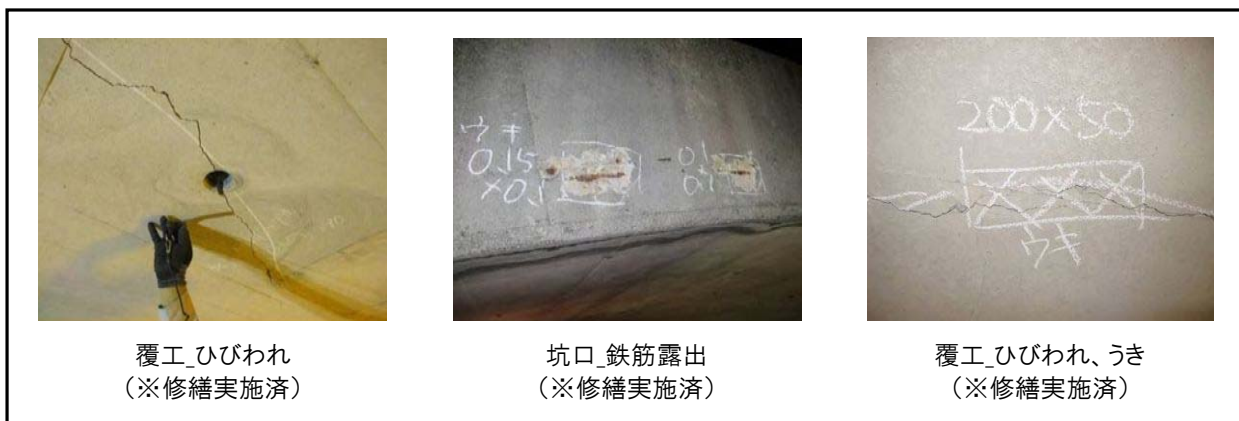
図-3 トンネルの主な変状
